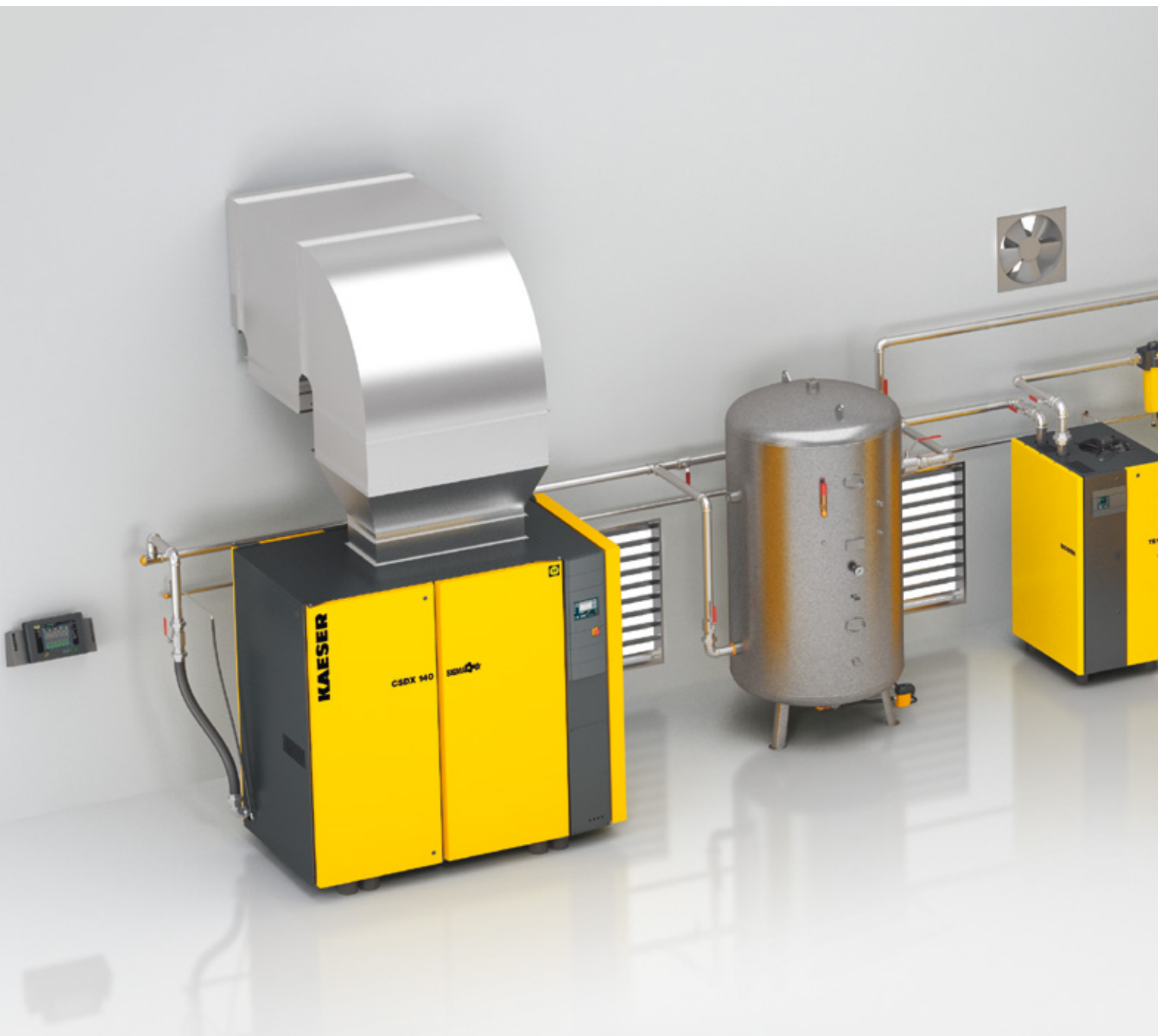
Abb.: Druckluftstation - Nieder- und Hochdruck
