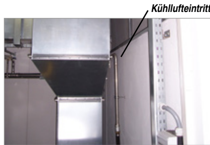
Abb. 2a: Zentrale Kühlluftfiltermatten
