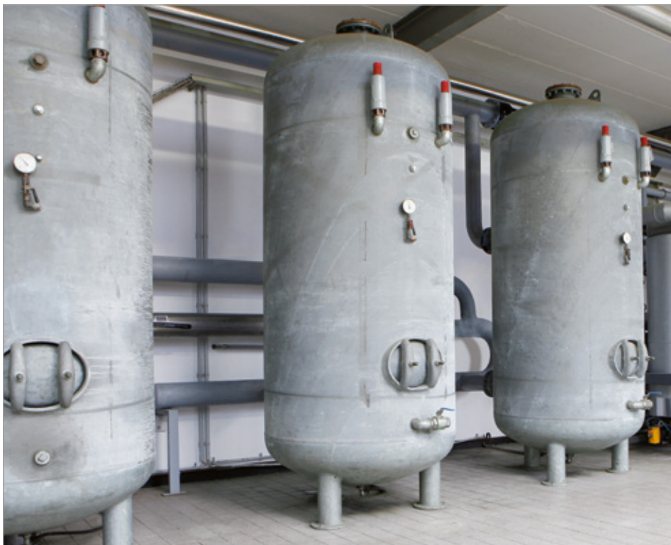
Abb. 4: Druckluftbehälter als Pufferspeicher
