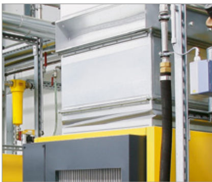
Abb. 2: Lüftungsanschluss des Kompressors mit Segeltuchstutzen
